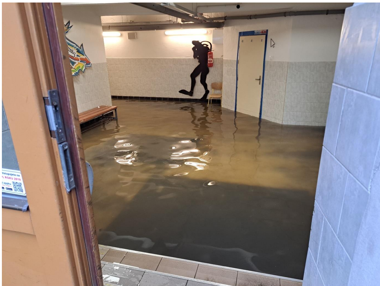
Obrázek 2 – zatopení suterénu školy přívalovým deštěm – vstup pro žáky do šaten
